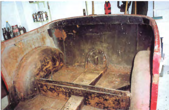
Bund og hjulkasser var meget dårlige...
