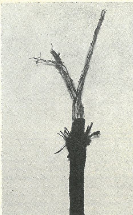
Denne ledning var tilsyneladende korrekt monteret, men den så alligevel lidt „tynd“ ud i forbindelsen. Da isolationen blev taget bort, var flere tråde knækket på grund af korrosion og mishandling — bundtst til venstre havde ikke mekanisk kontakt med strømaftagerens klemmsko.
